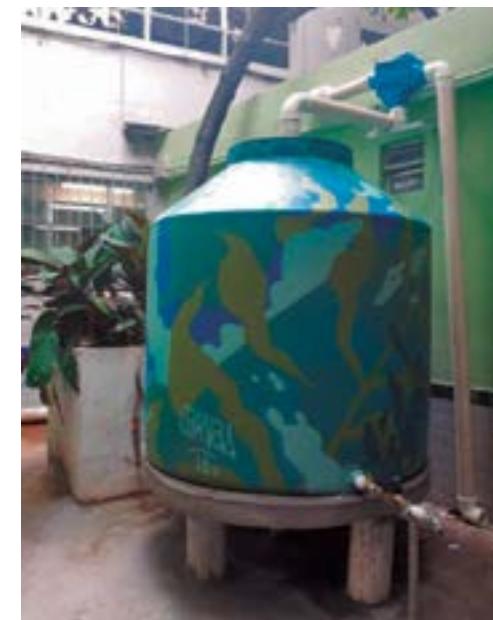
Figura 1 Coletor de águas pluviais Fonte: DISAI (2019)
