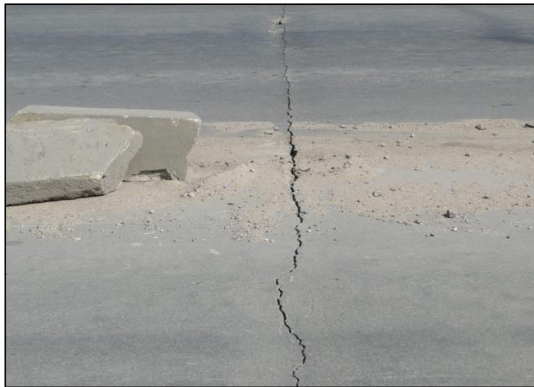
FIGURA 25: Fissuras no pavimento onde se encontram as juntas de dilatação [20].
