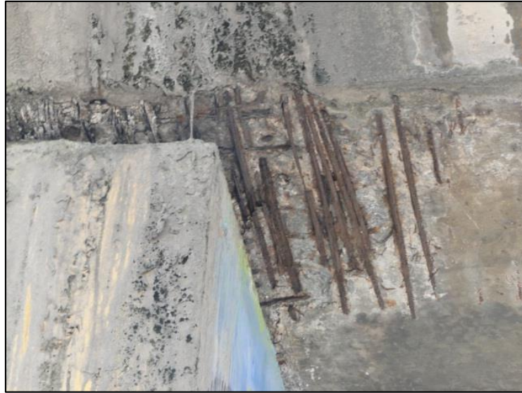
FIGURA 24: Corrosão das armaduras decorrente das infiltrações de água pelas aberturas das juntas [20].
